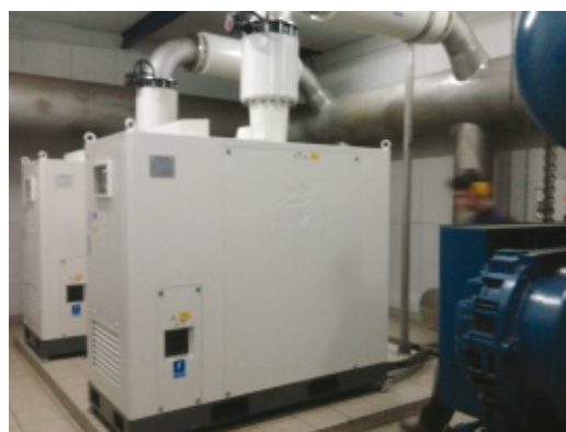
rok 2013 ČOV Bielsko-Biała Komorowice, dmychadlová stanice č. 2
