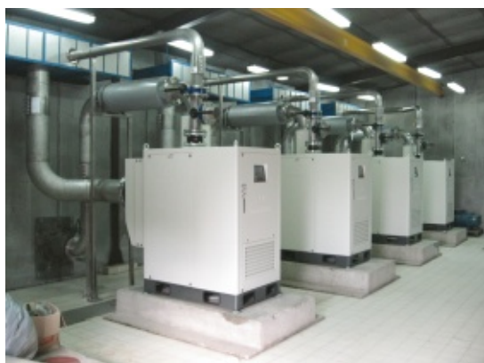
rok 2011 ČOV Dębica dmychadła: 4 ks MAX90
