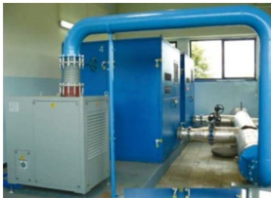
rok 2009 ČOV Tychy - Urbanowice, dmychadlová stanice č. 1
