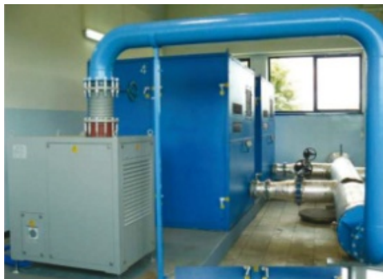
2009 г. СОСВ Тыхы - Урбановице, станция воздухоувок № 1 воздухоувки: 1 шт. МАХ75
