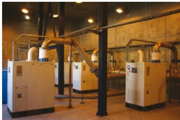
2011 г. СОСВ Тыхы - Урбановице, станция воздухоувок № 2 воздухоувки: 5 шт. МАХ100
