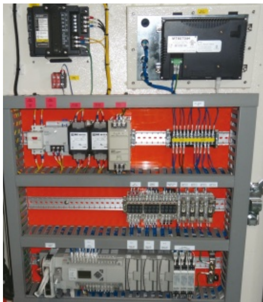
Образец функционального распорядителя PLC вместе с оборудованием и сенсорной панелью, встроенной в воздуходувку.
