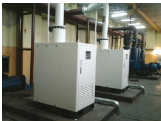
2011 г. СОСВ Бельско-Бяла - Коморовице, станция воздухоувок № 1 воздухоувки: 2 шт. МАХ75
