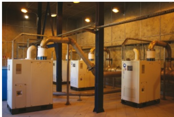
2011 г. СОСВ Тыхы - Урбановице, станция повітродувок № 2 повітродувки: 5 шт. MAX100
