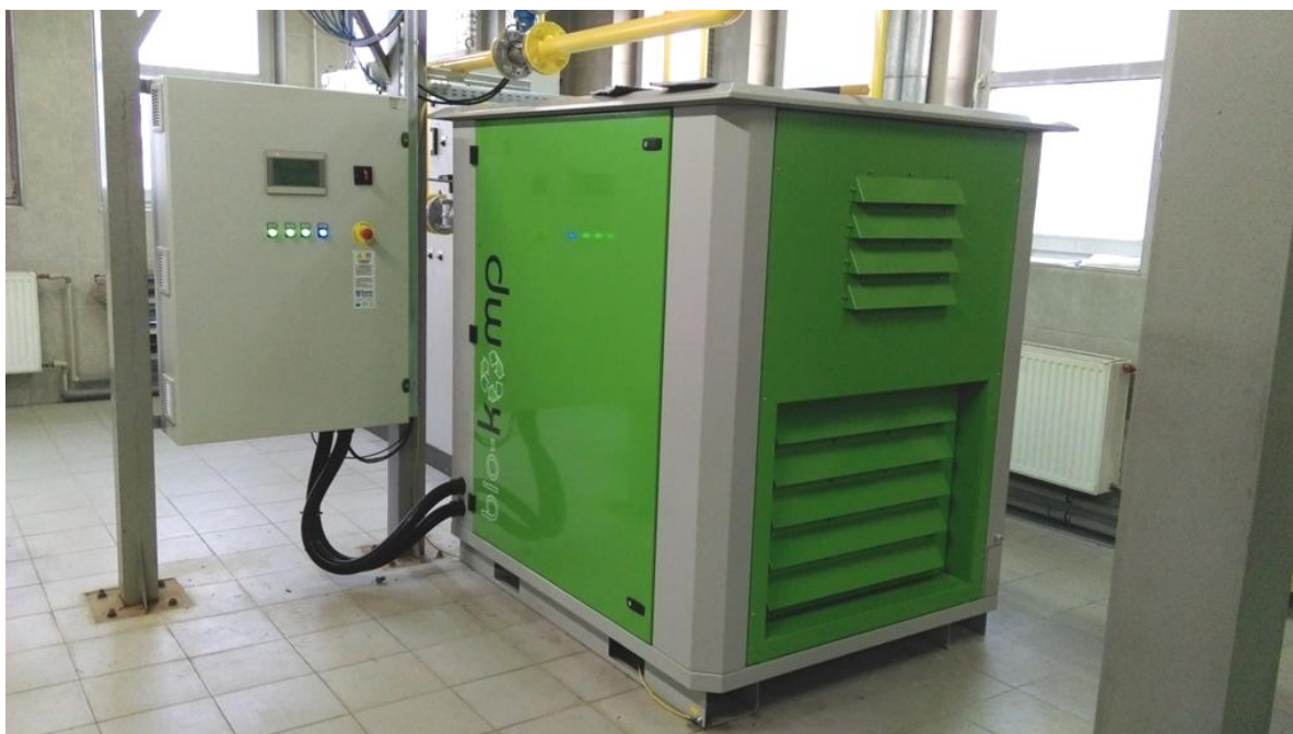
Kompaktowy układ uzdatniania biogazu.
