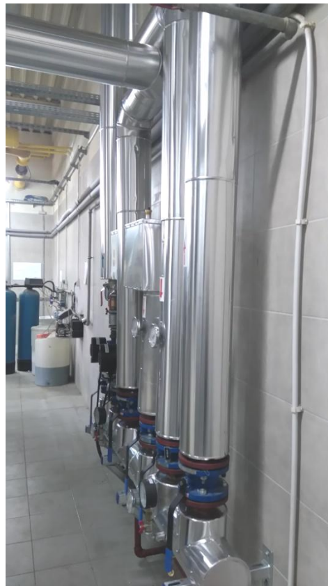
Układ pompowy i mieszalniki.
